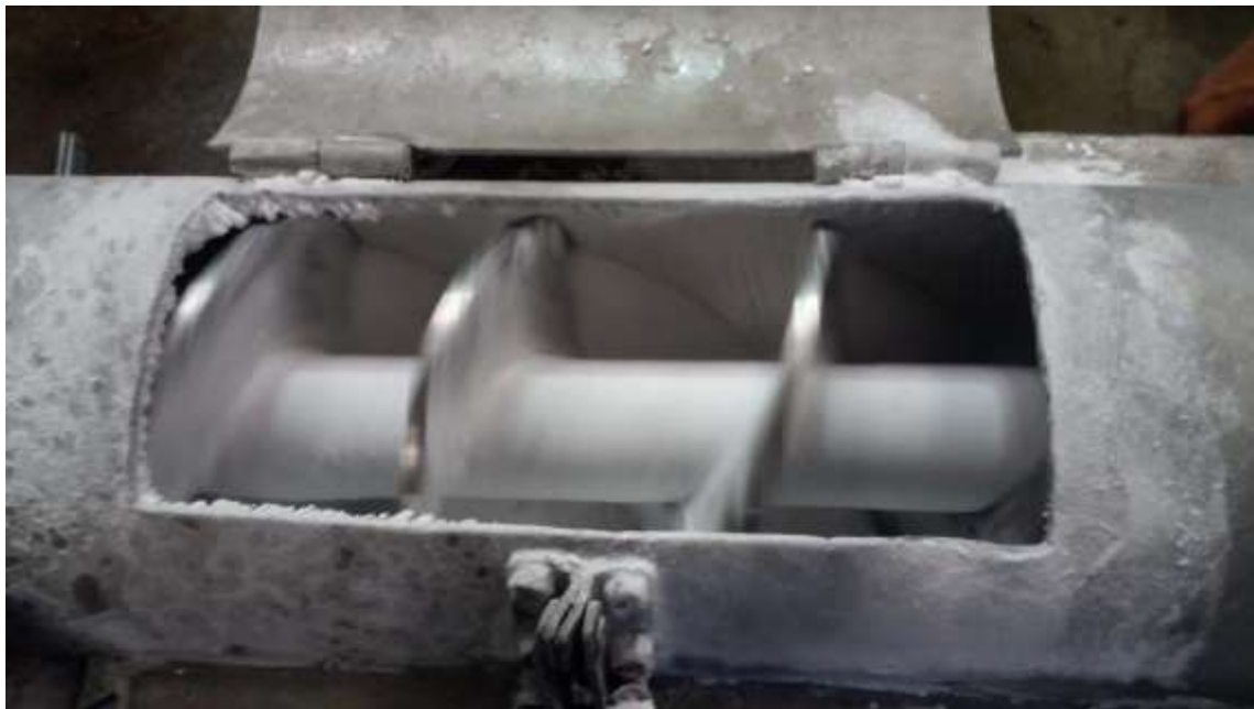
Figura 8 - Sistema de perda de calor via rosca sem fim na empresa UnaProsil.
