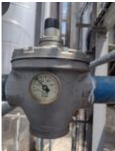
Figura 8: Controladora de pressão, reduzindo a pressão para 3 kgf/cm 2 .
