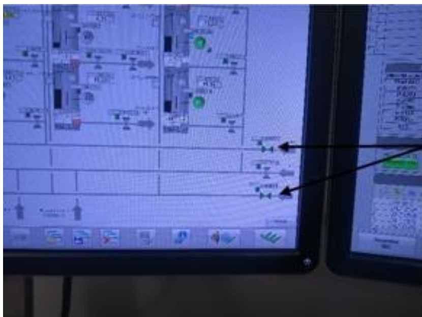
Figura 11: Sistema operacional do processo, indicando pelas setas a sopragem nas tubulações sendo realizadas simultaneamente com o sistema automático.
