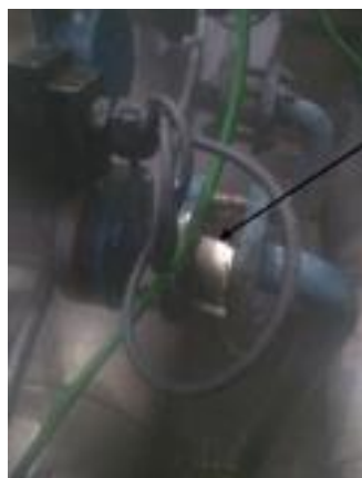
Figura 3: Remoção da retenção para desobstrução da linha de sopagem. Produto encontrava-se solidificado nas tubulações de ar comprimido. Fonte: Dos autores, 2023.
