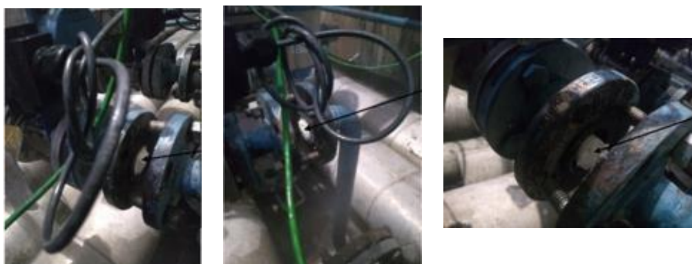
Figura 4- Tubulação de ar comprimido com produto solidificado. Local que não deveria haver gordura. Fonte: Dos autores, 2023..
