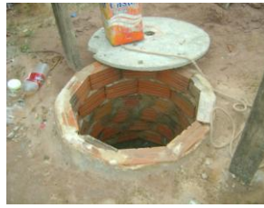
Figura 04 - Poço apresentando péssimas condições de higiene.
