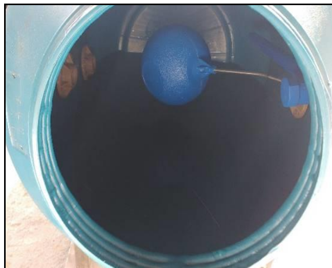
Figura 4 – Interior da bombona com sistema de torneira boia
