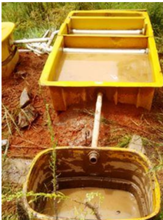
Figura 10 – Caixa separadora água e óleo após limpeza
