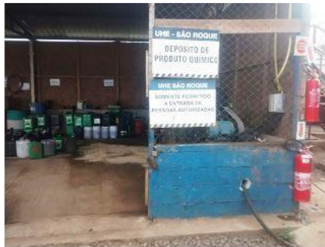
Figura 7 – Depósito e armazenamento de resíduos oleosos
